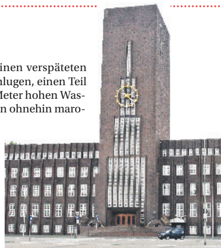
Der 49 Meter hohe Turm ist so marode, dass er komplett saniert werden muss. Foto: WZ-Bildienst
